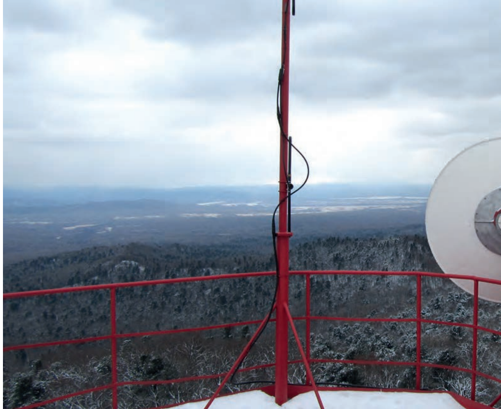
Радиорелейная станция в п. Глебово (узел связи «Хабаровск»)
